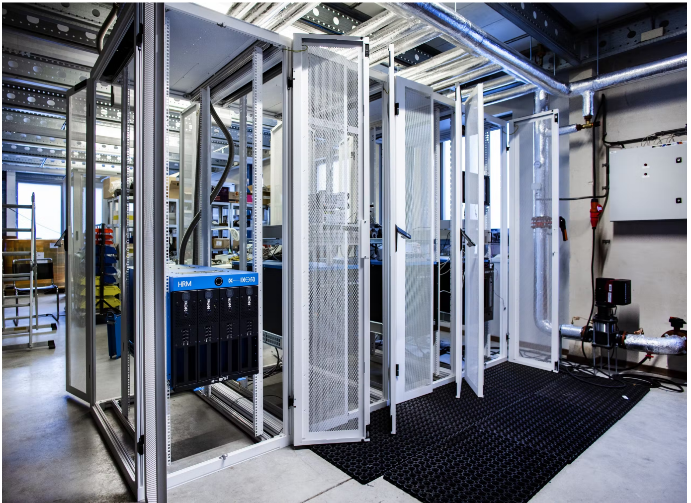
Proefopstelling van het koelsysteem van iXora. De apparatuur is in te passen in de standaardmaten van een datacenter. Foto: Ramon van Flymen voor het FD
